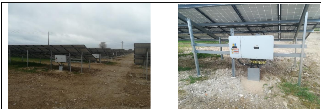
Vues sur un onduleur et câble enfoui dans le sol (Source TotalEnergies)
