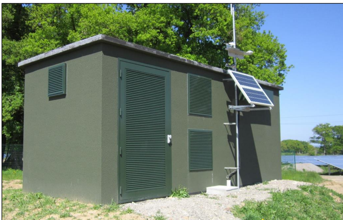
Exemple de poste de livraison (Source : TotalEnergies)
